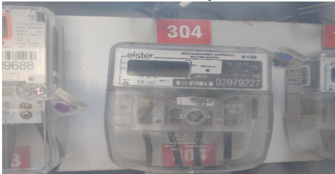
Contador de Energia
