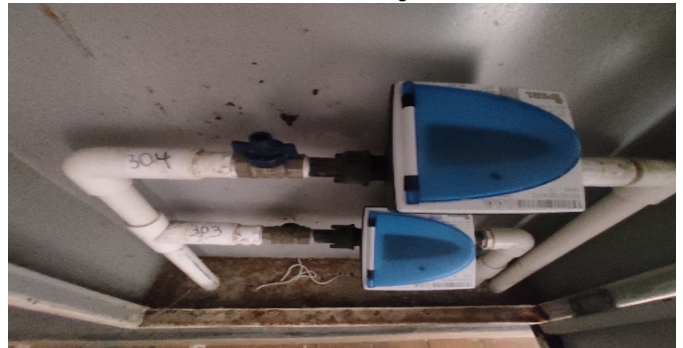
Contador de Agua
