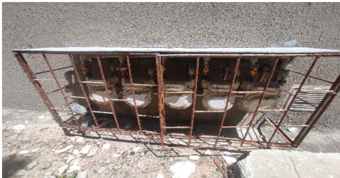
Contador de Gas
