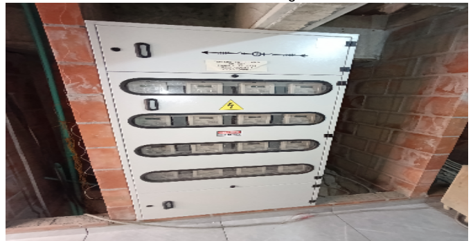
Contador de Energia
