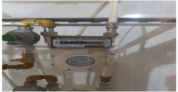
Contador de Gas
