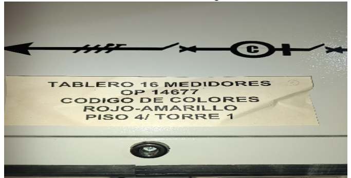
Contador de Energia
