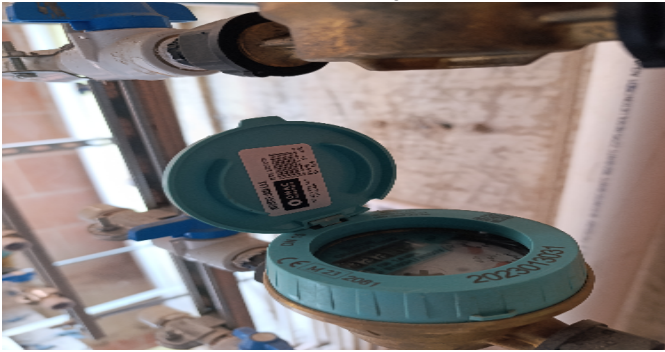
Contador de Agua
