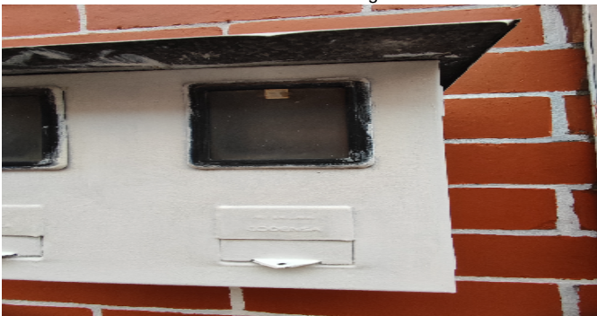
Contador de Energia
