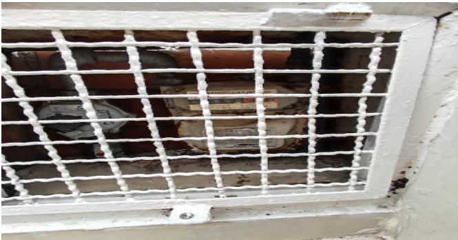
Contador de Gas
