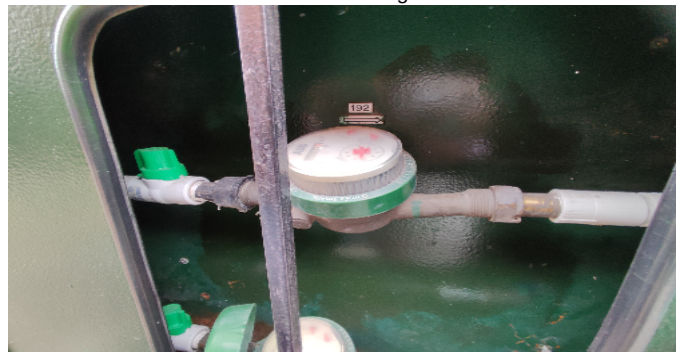
Contador de Agua
