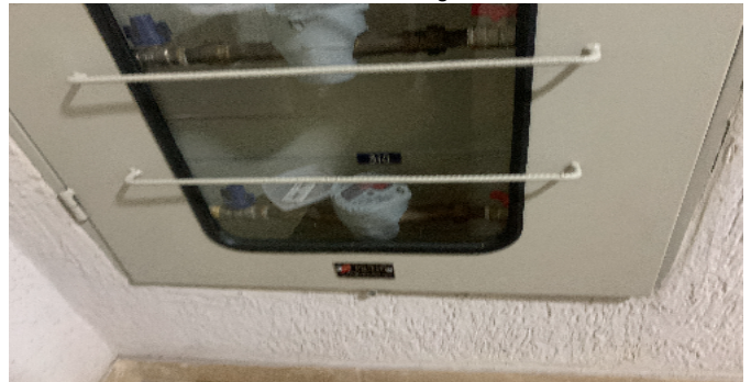
Contador de Agua
