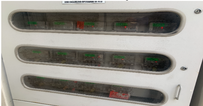
Contador de Energia
