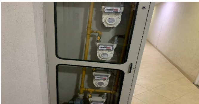
Contador de Gas
