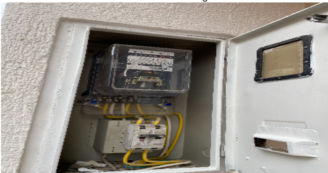
Contador de Energia
