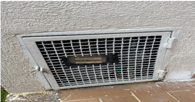
Contador de Gas
