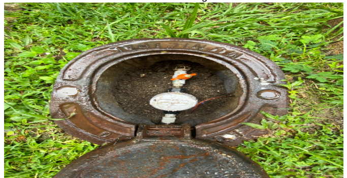
Contador de Agua
