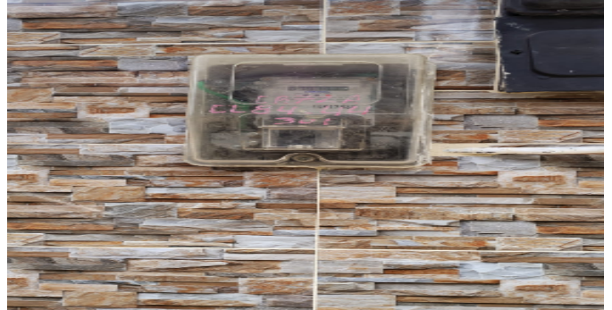
Contador de Energia
