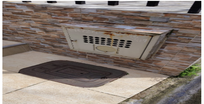
Contador de Gas
