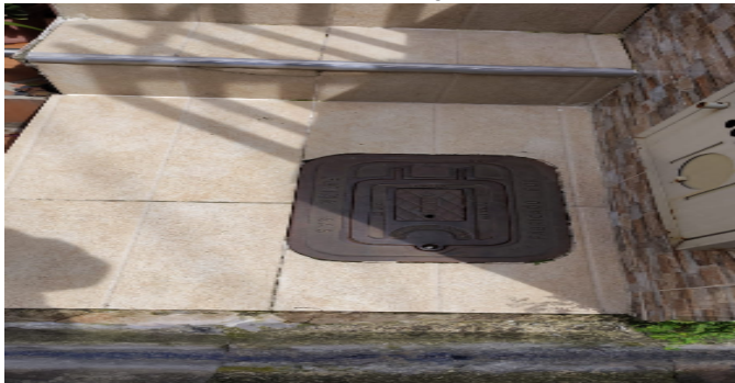
Contador de Agua
