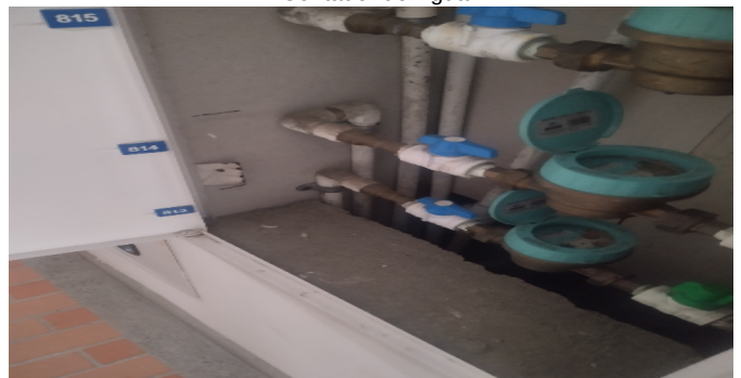
Contador de Agua
