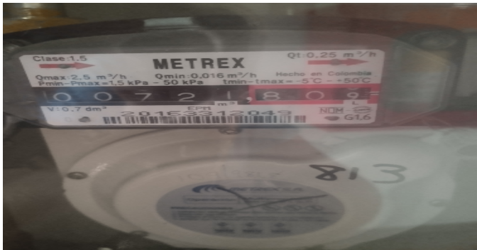
Contador de Gas
