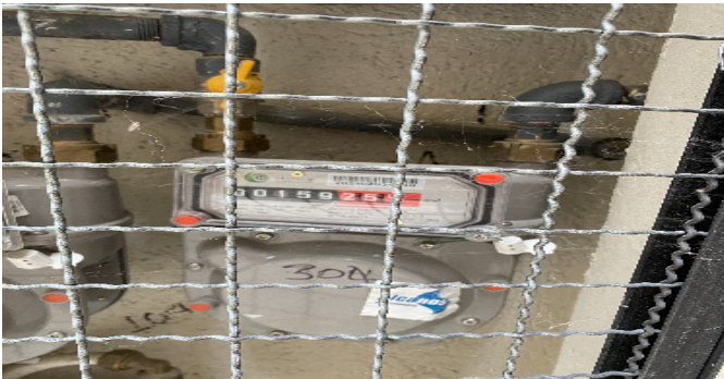
Contador de Gas
