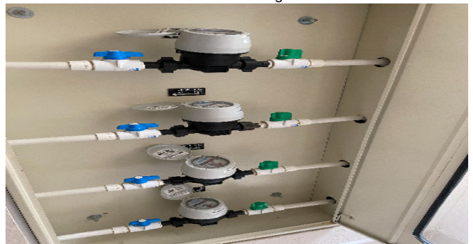
Contador de Agua
