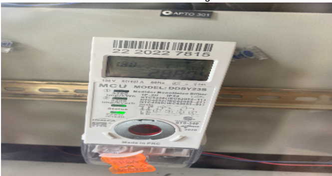
Contador de Energia
