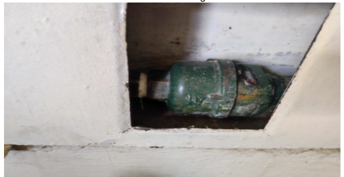
Contador de Agua
