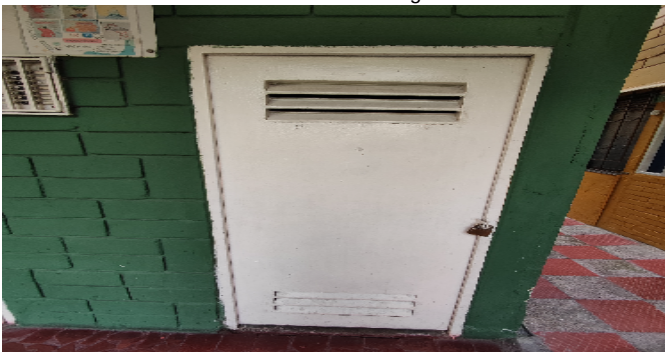
Contador de Energia
