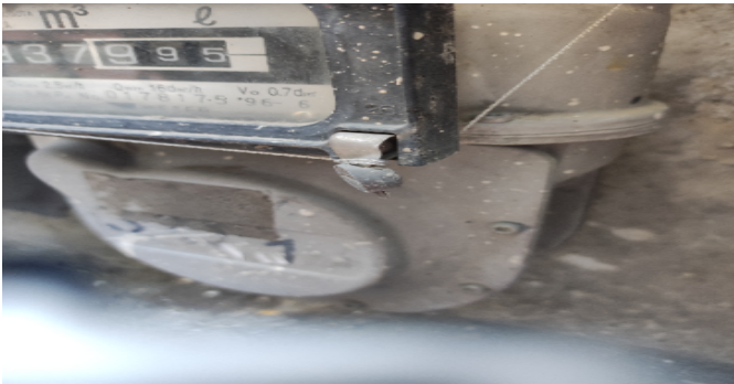
Contador de Gas
