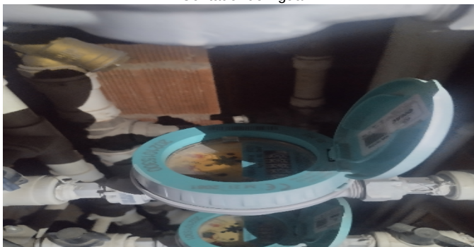
Contador de Agua
