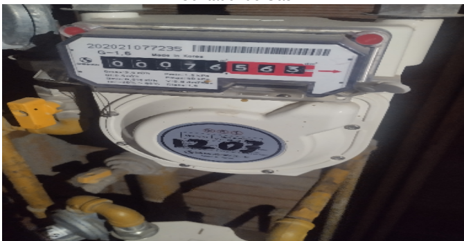
Contador de Gas
