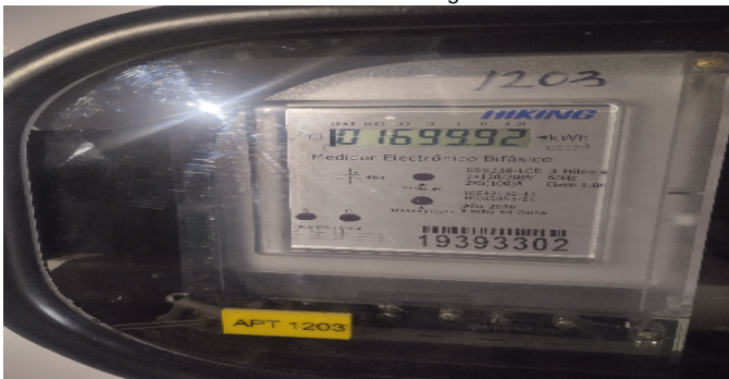
Contador de Energia
