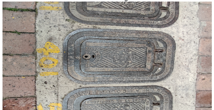
Contador de Agua
