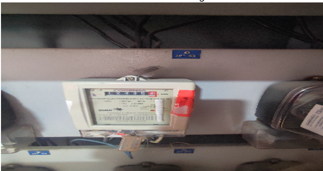
Contador de Energia
