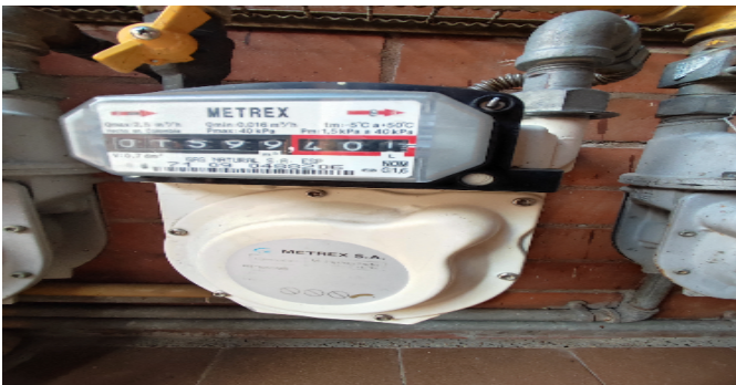
Contador de Gas
