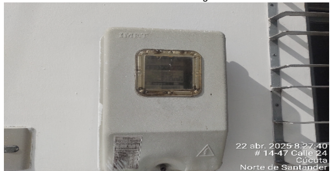
Contador de Energia
