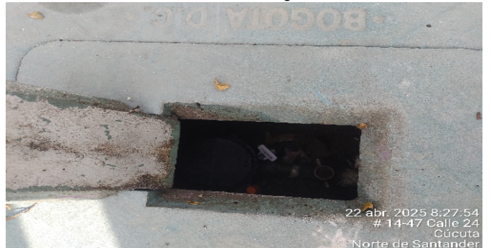
Contador de Agua
