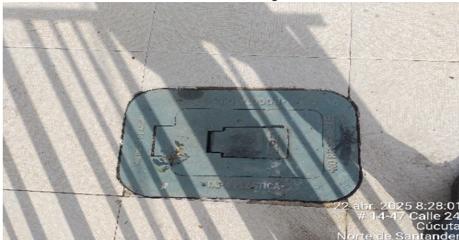
Contador de Agua
