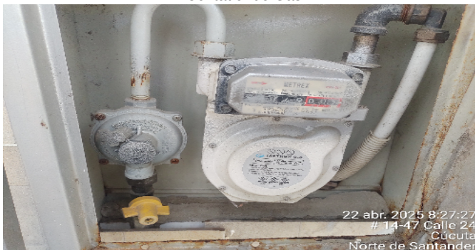
Contador de Gas
