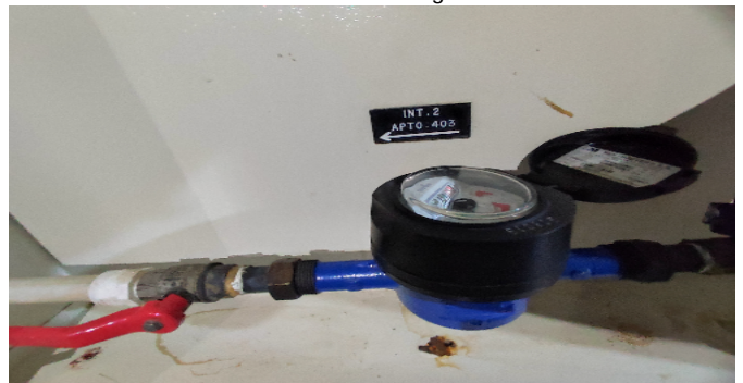
Contador de Agua
