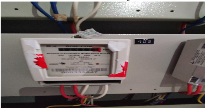
Contador de Energia
