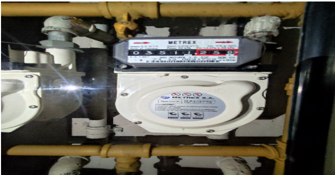
Contador de Gas
