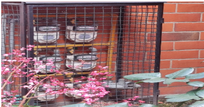
Contador de Gas
