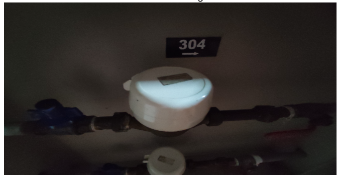
Contador de Agua
