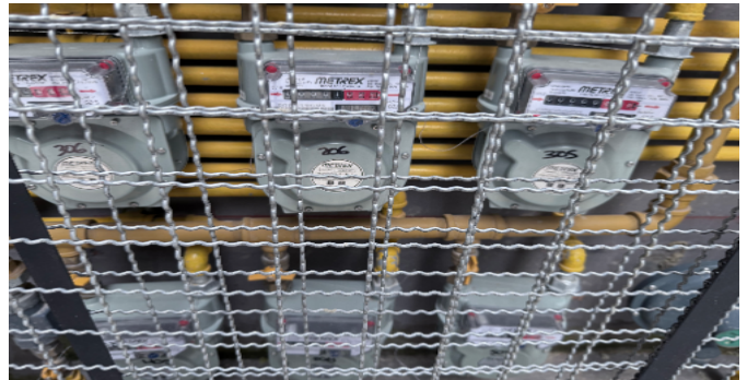
Contador de Gas
