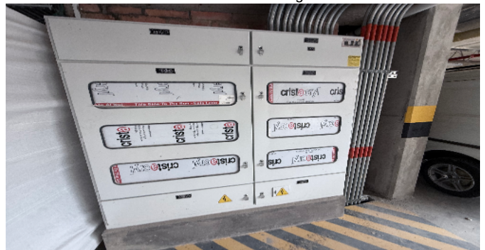
Contador de Energia
