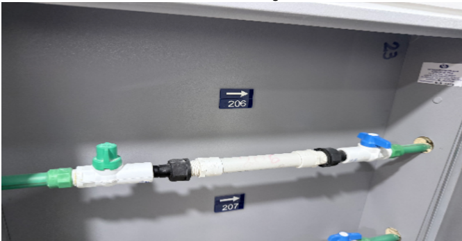
Contador de Agua
