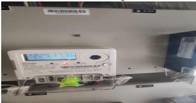
Contador de Energia
