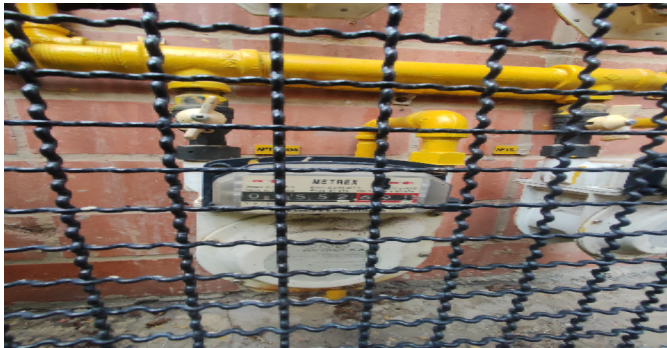
Contador de Gas
