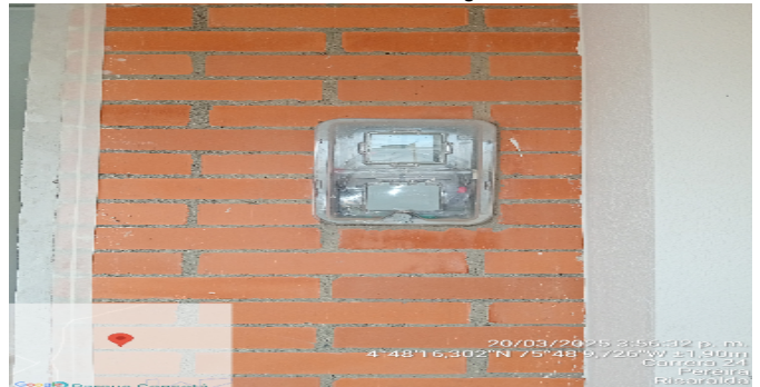
Contador de Energia
