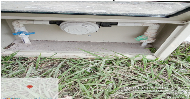
Contador de Agua
