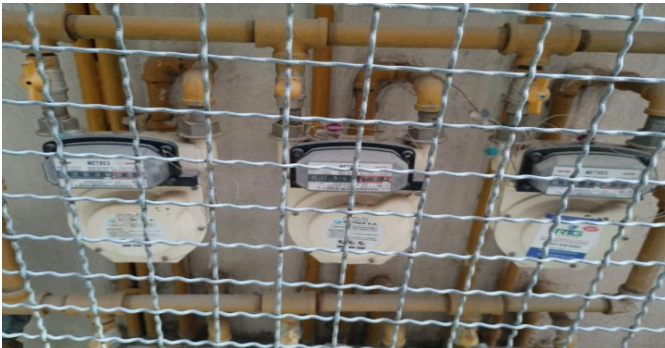
Contador de Gas
