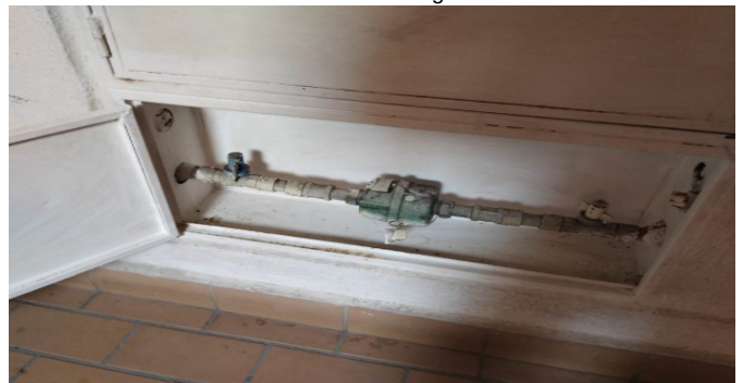
Contador de Agua
