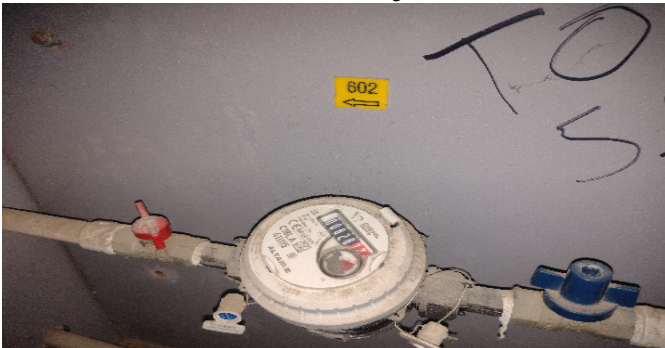
Contador de Agua
