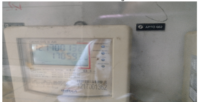
Contador de Energia
