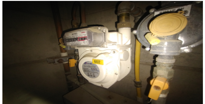
Contador de Gas
