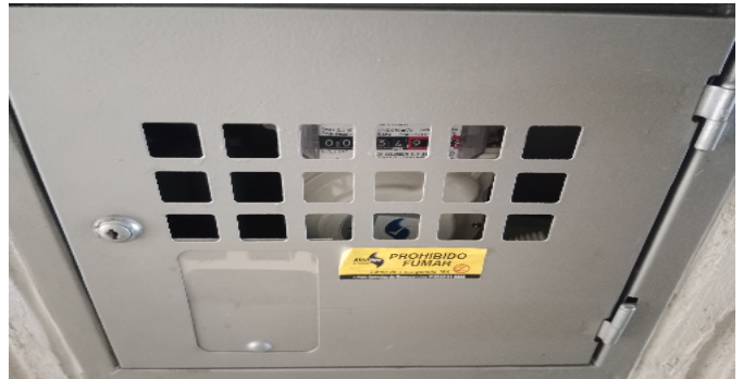
Contador de Gas
