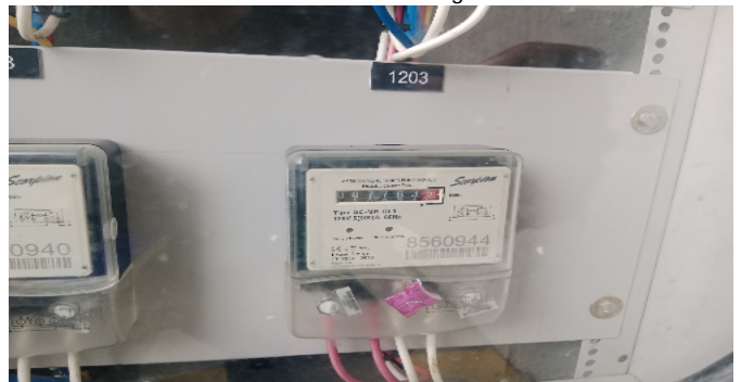
Contador de Energia
