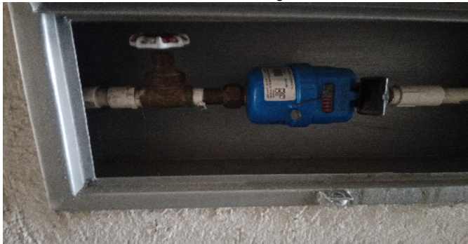
Contador de Agua
