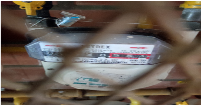
Contador de Gas
