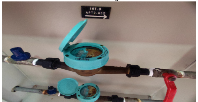
Contador de Agua
