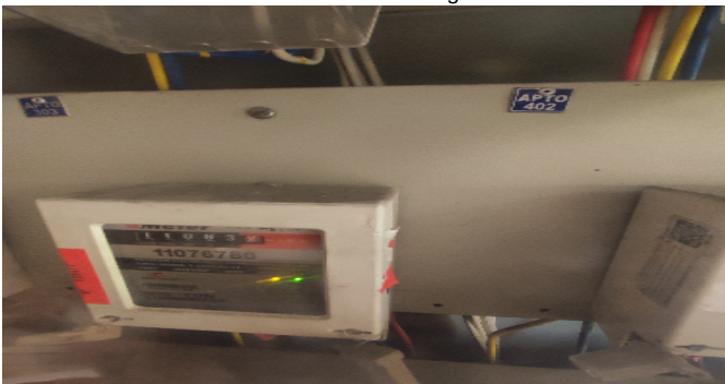
Contador de Energia
