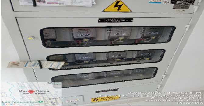
Contador de Energia
