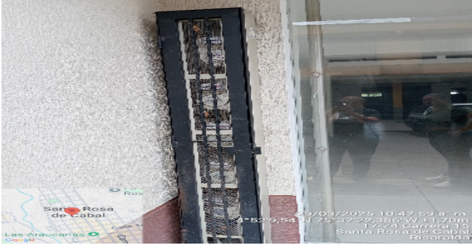
Contador de Gas
