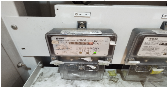
Contador de Energia
