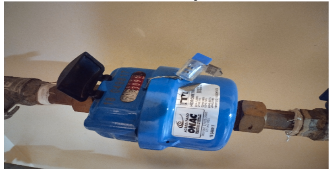
Contador de Agua
