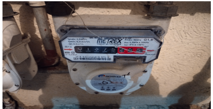
Contador de Gas
