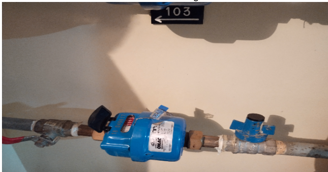
Contador de Agua
