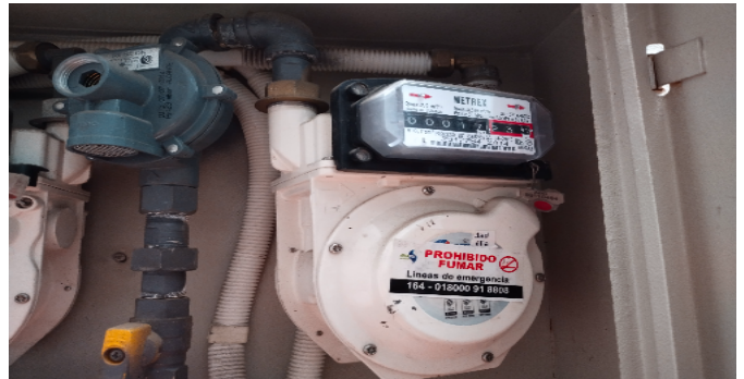
Contador de Gas
