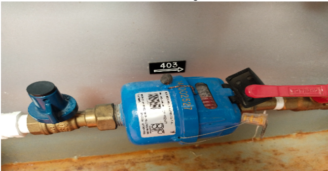
Contador de Agua
