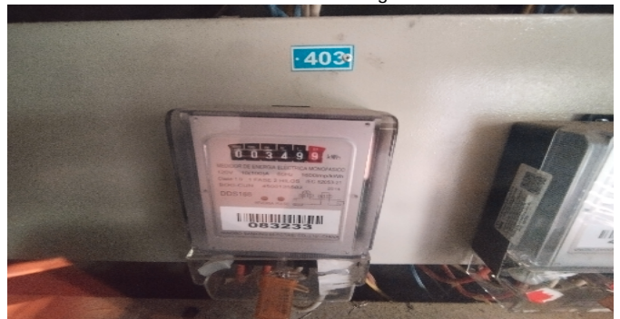
Contador de Energia
