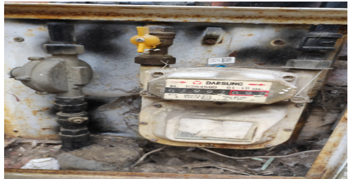
Contador de Gas
