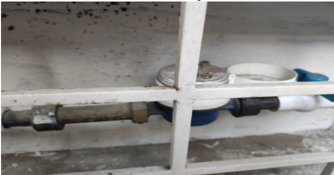
Contador de Agua
