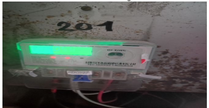
Contador de Energia
