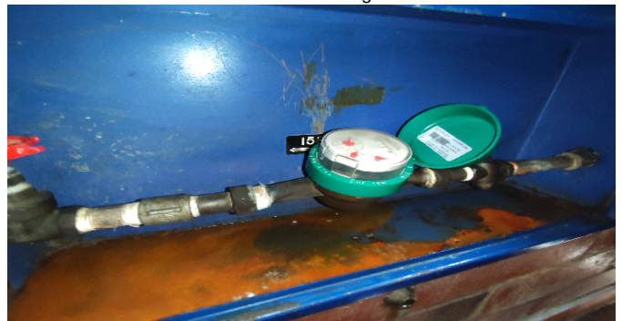
Contador de Agua
