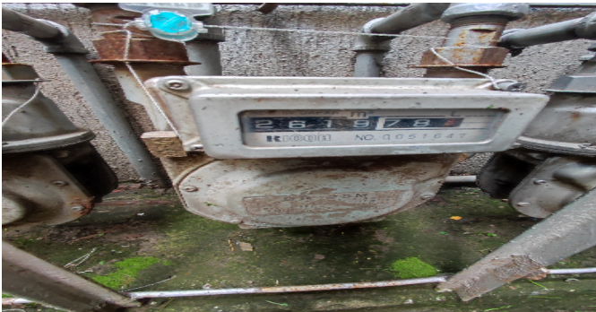
Contador de Gas
