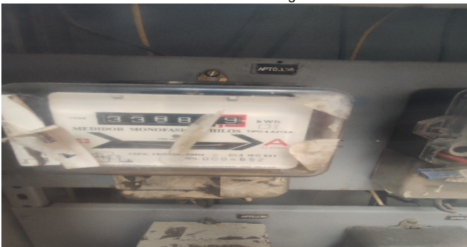
Contador de Energia
