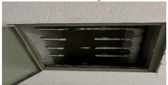
Contador de Agua
