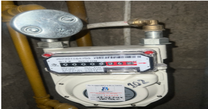
Contador de Gas
