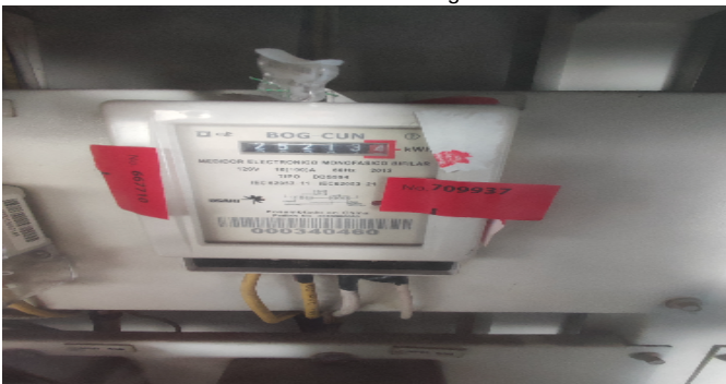
Contador de Energia
