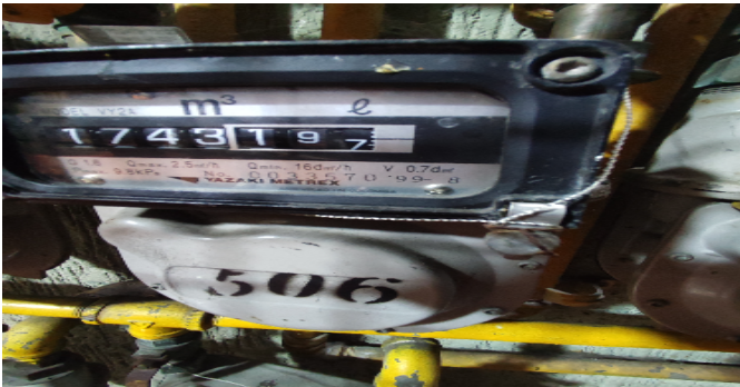
Contador de Gas
