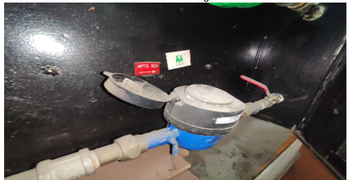
Contador de Agua
