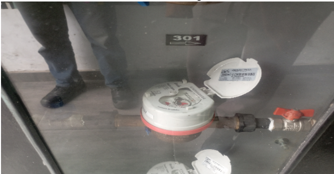
Contador de Agua
