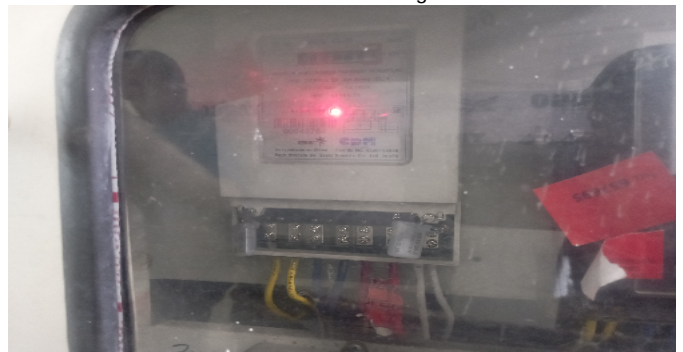
Contador de Energia
