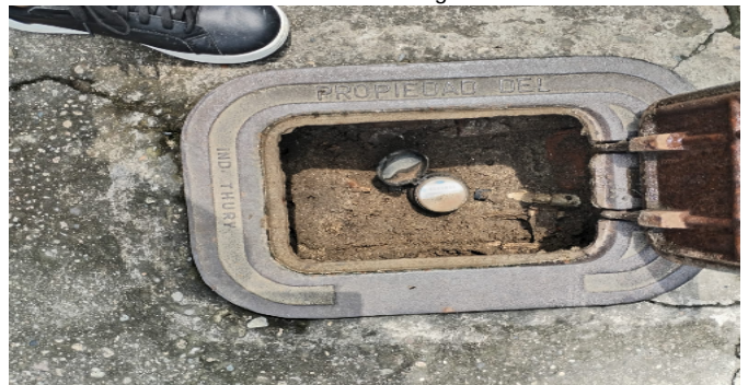
Contador de Agua
