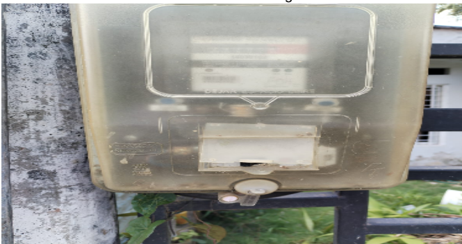
Contador de Energia
