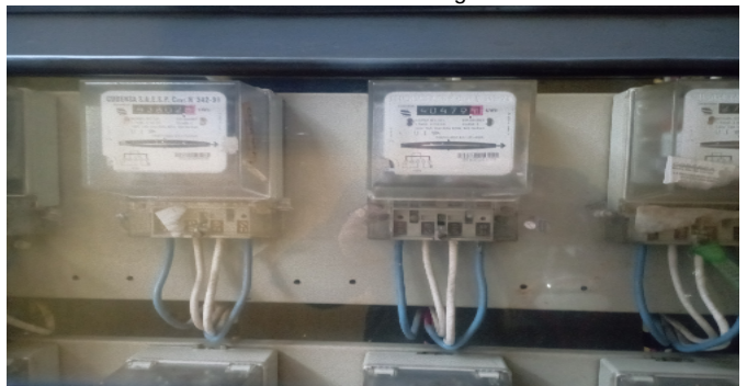
Contador de Energia
