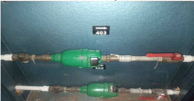
Contador de Agua
