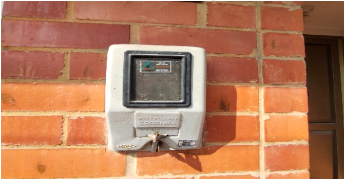
Contador de Energia
