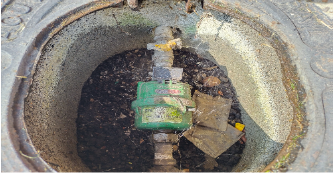
Contador de Agua
