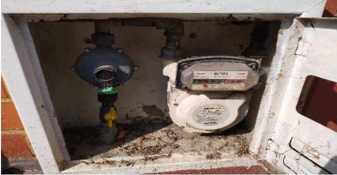
Contador de Gas
