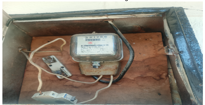
Contador de Energia
