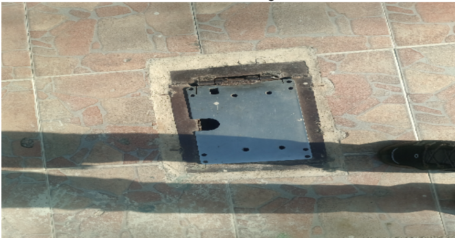
Contador de Agua
