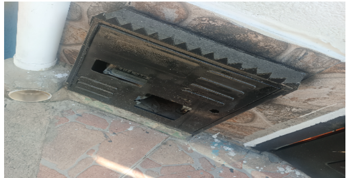
Contador de Gas
