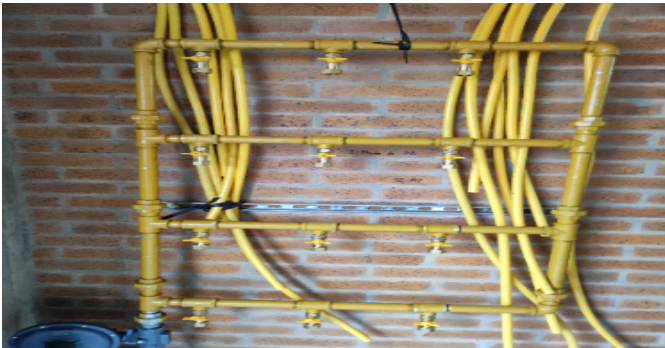
Contador de Gas
