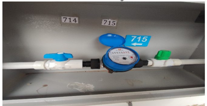
Contador de Agua
