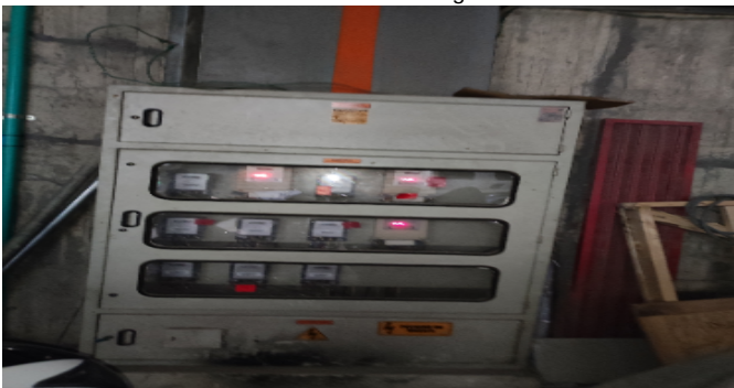
Contador de Energia
