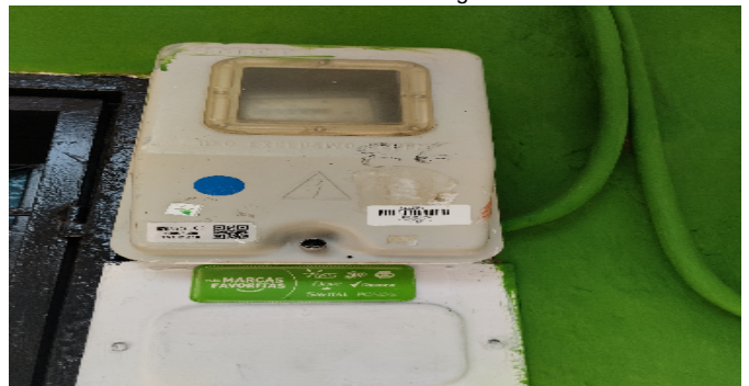
Contador de Energia
