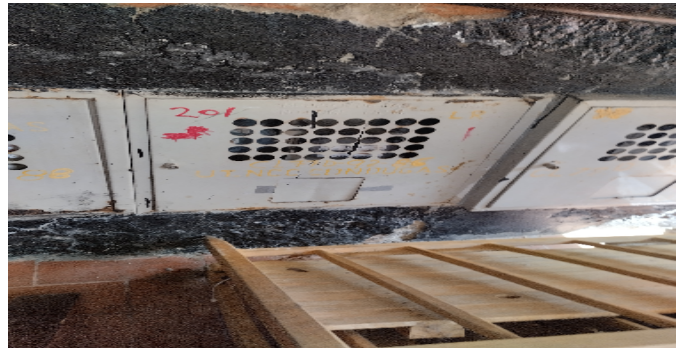
Contador de Gas
