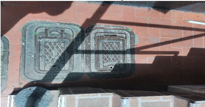
Contador de Agua
