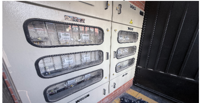
Contador de Energia
