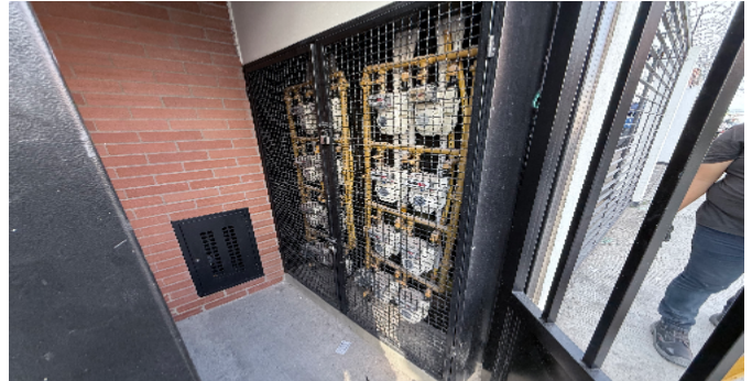
Contador de Gas
