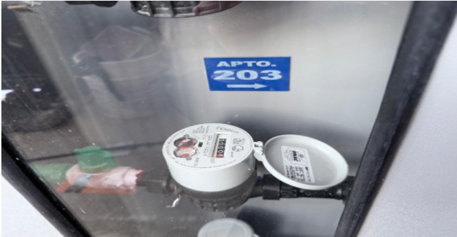
Contador de Agua
