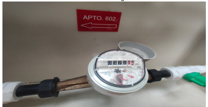
Contador de Agua
