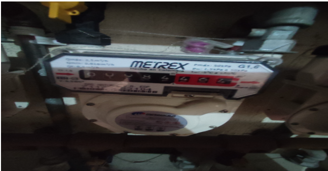
Contador de Gas
