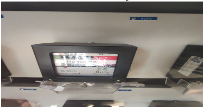
Contador de Energia
