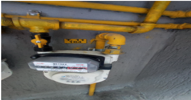
Contador de Gas
