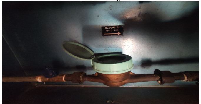
Contador de Agua
