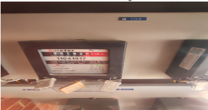
Contador de Energia
