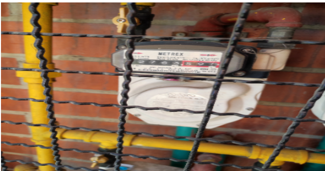
Contador de Gas
