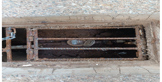
Contador de Agua
