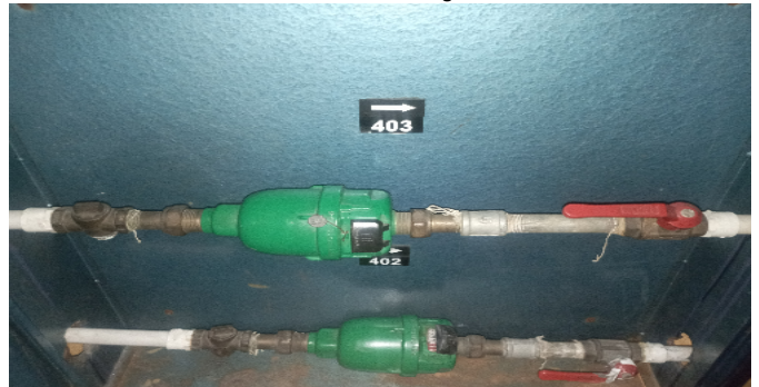
Contador de Agua
