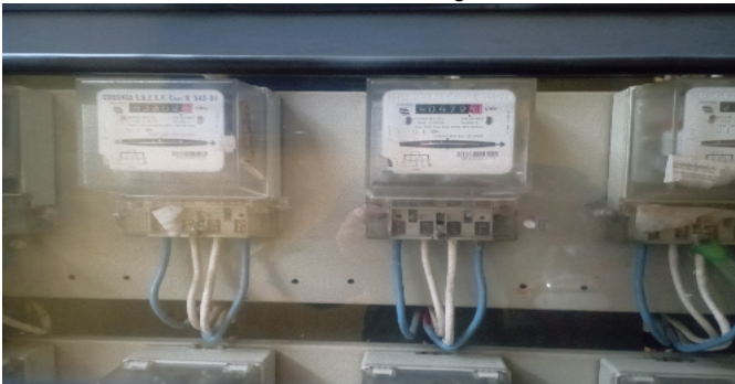
Contador de Energia
