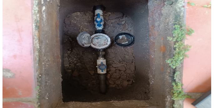
Contador de Agua
