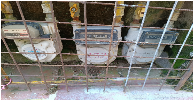
Contador de Gas
