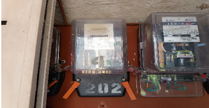
Contador de Energia
