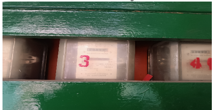
Contador de Energia
