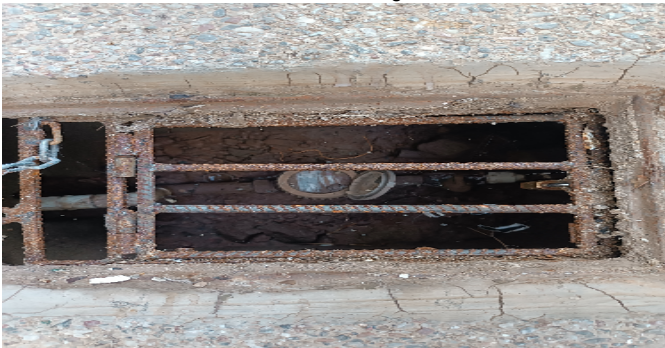
Contador de Agua
