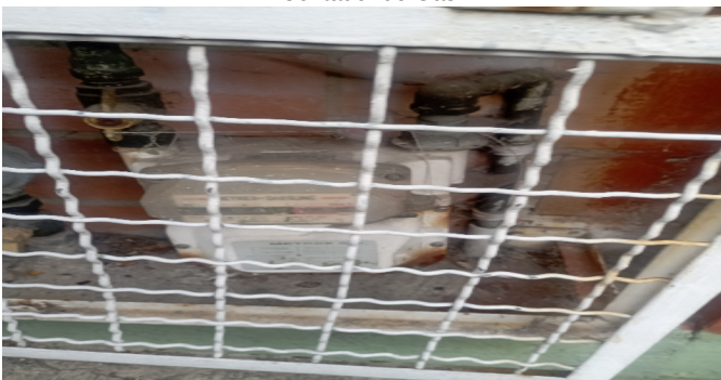
Contador de Gas
