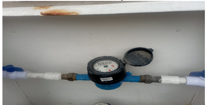
Contador de Agua
