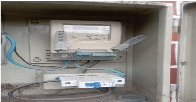
Contador de Energia
