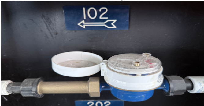
Contador de Agua
