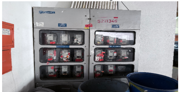
Contador de Energia
