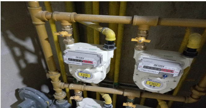
Contador de Gas
