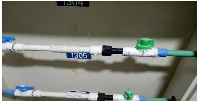
Contador de Agua
