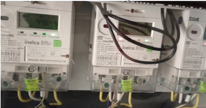
Contador de Energia
