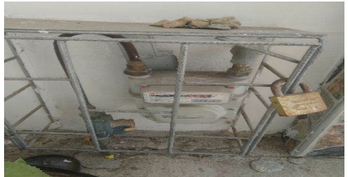
Contador de Gas
