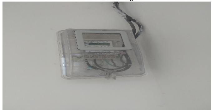
Contador de Energia
