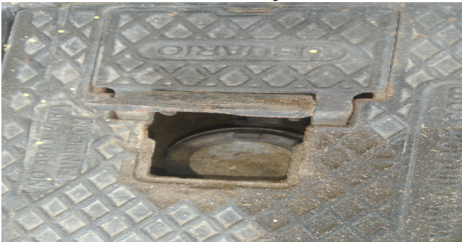
Contador de Agua
