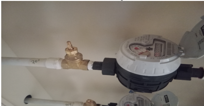
Contador de Agua
