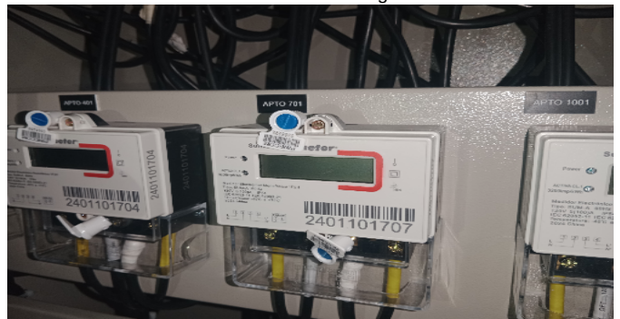
Contador de Energia
