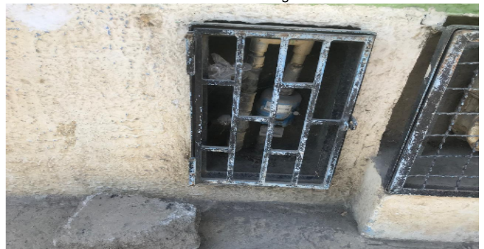
Contador de Agua
