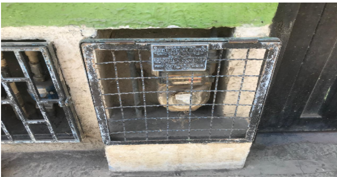
Contador de Gas
