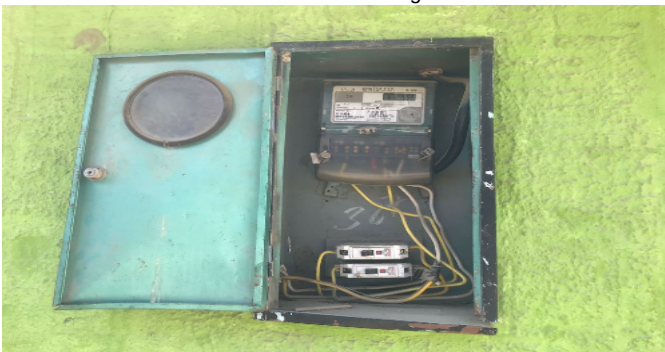
Contador de Energia
